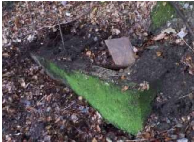
Prise d'eau sur le chemin du Bos dans la forêt, en face du Prat Nouvel
